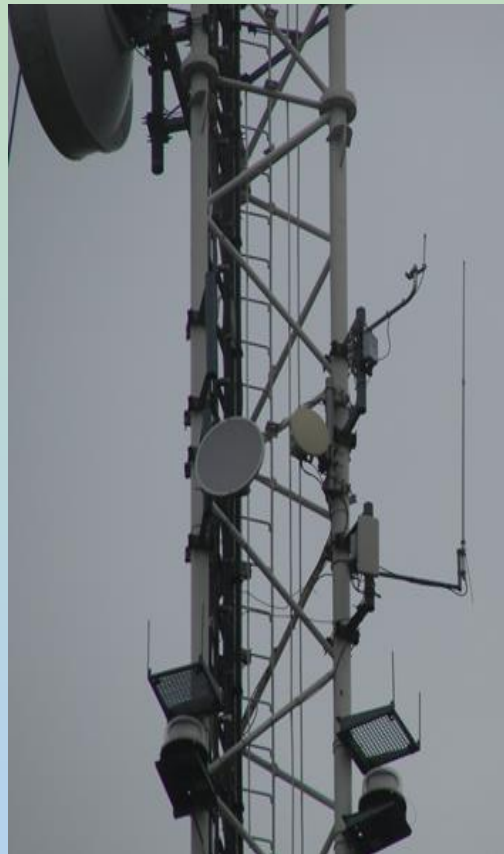
Stacja bazowa LPWAN LoRa z anteną
