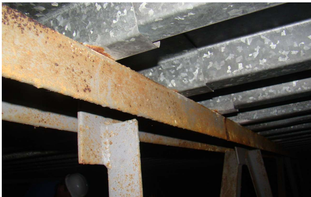
foto 6 Korozja dolnej faldy blachy trapezowej i pasa górnego płatwi kratowej w miejscu ich styku.
