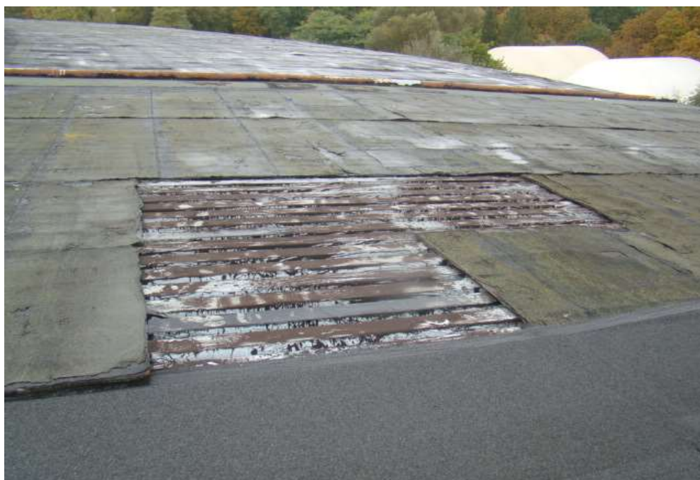
foto 4 Zerwana przez wiatr połąć pokrycia papowego dachu wraz z płytą pilśniową.
