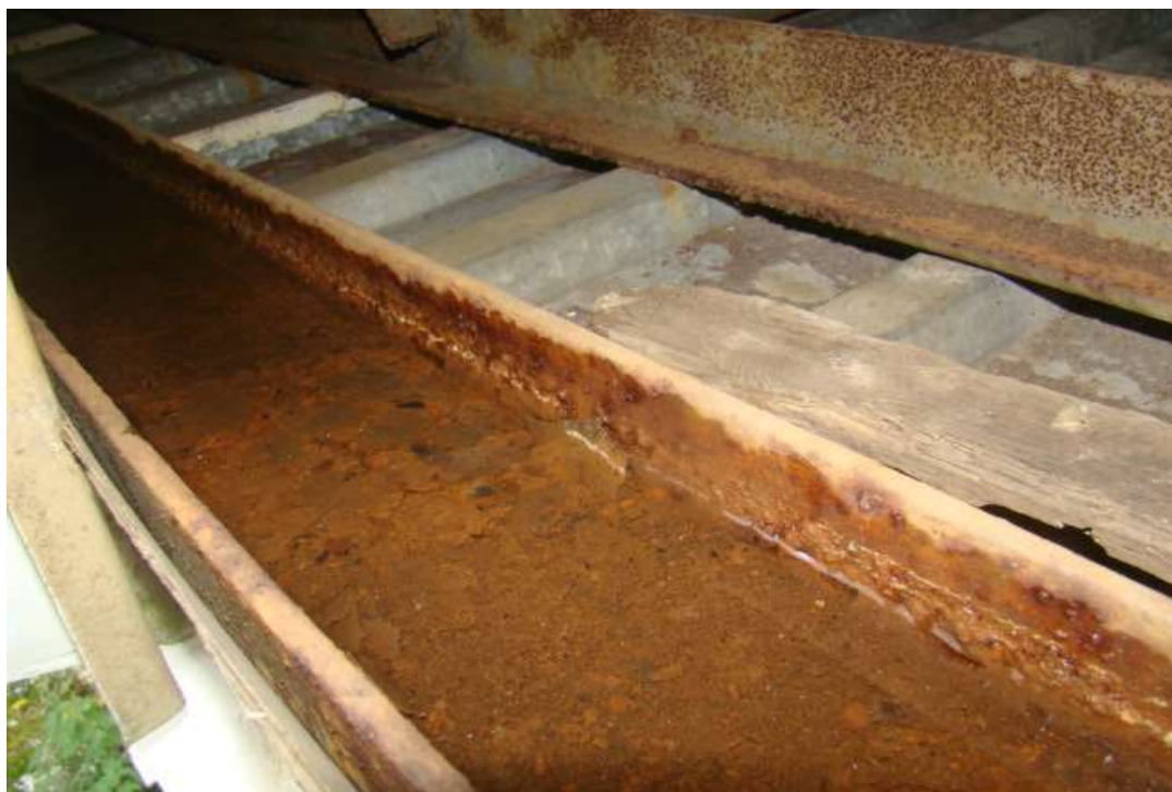
foto 5 Skorodowany, wypełniony wodą ,pas górny konstrukcji mocującej przeszklenie ściany zewnętrznej okalającej tor kolarski .
