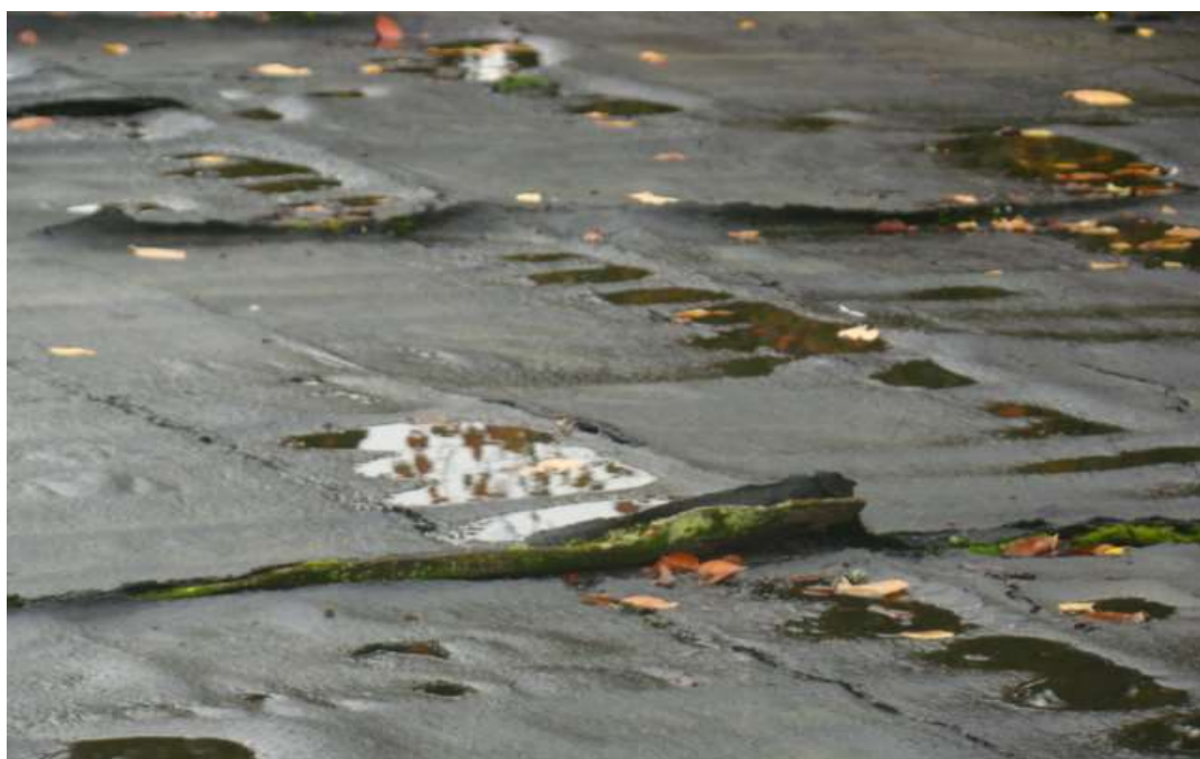
foto 2 Widok rozerwanego po obrysach płyt pilśniowych pokrycia papowego dachu oraz niekształconych krawędzi płyt pilśniowych.
