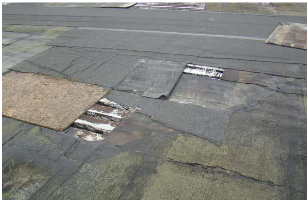
foto 3 Zerwana przez wiatr papa pokrycia dachu wraz z płytą pilśniową..
