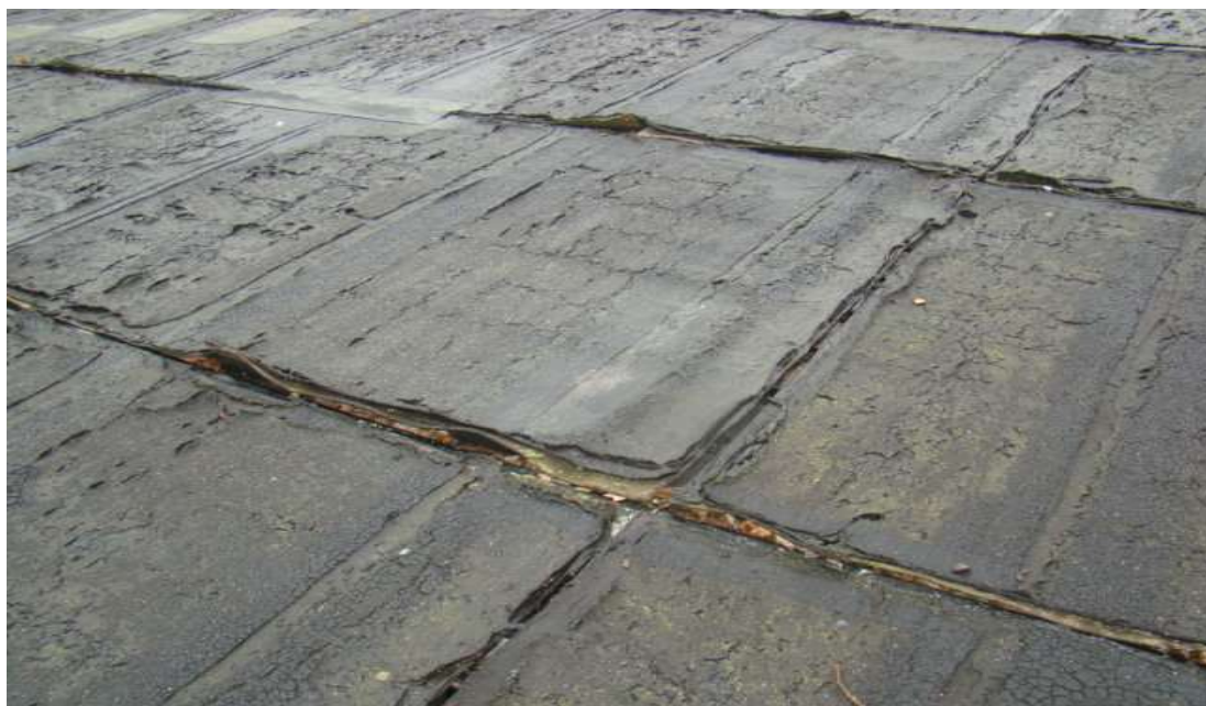
foto 1 Rozerwane po obrysach płyt pilśniowych pokrycie papowe dachu umożliwiające wnikanie wody opadowej.
