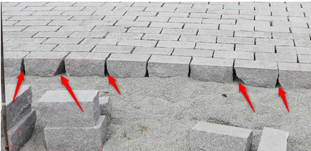
Fot. 6. Ubytki w kostce kamiennej w pracach brukarskich prowadzonych w lutym/marcu 2021 r. [www.skyscrapercity.com]
