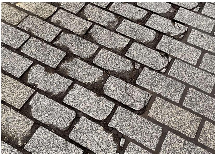
Fot. 4. Uszkodzenia fugi i kostki wraz z powstałymi nierównościami
