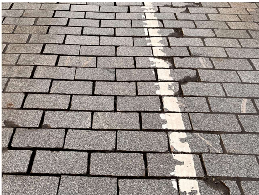
Fot. 3. Uszkodzenia spoiny i kostki wraz z powstałymi nierównościami
