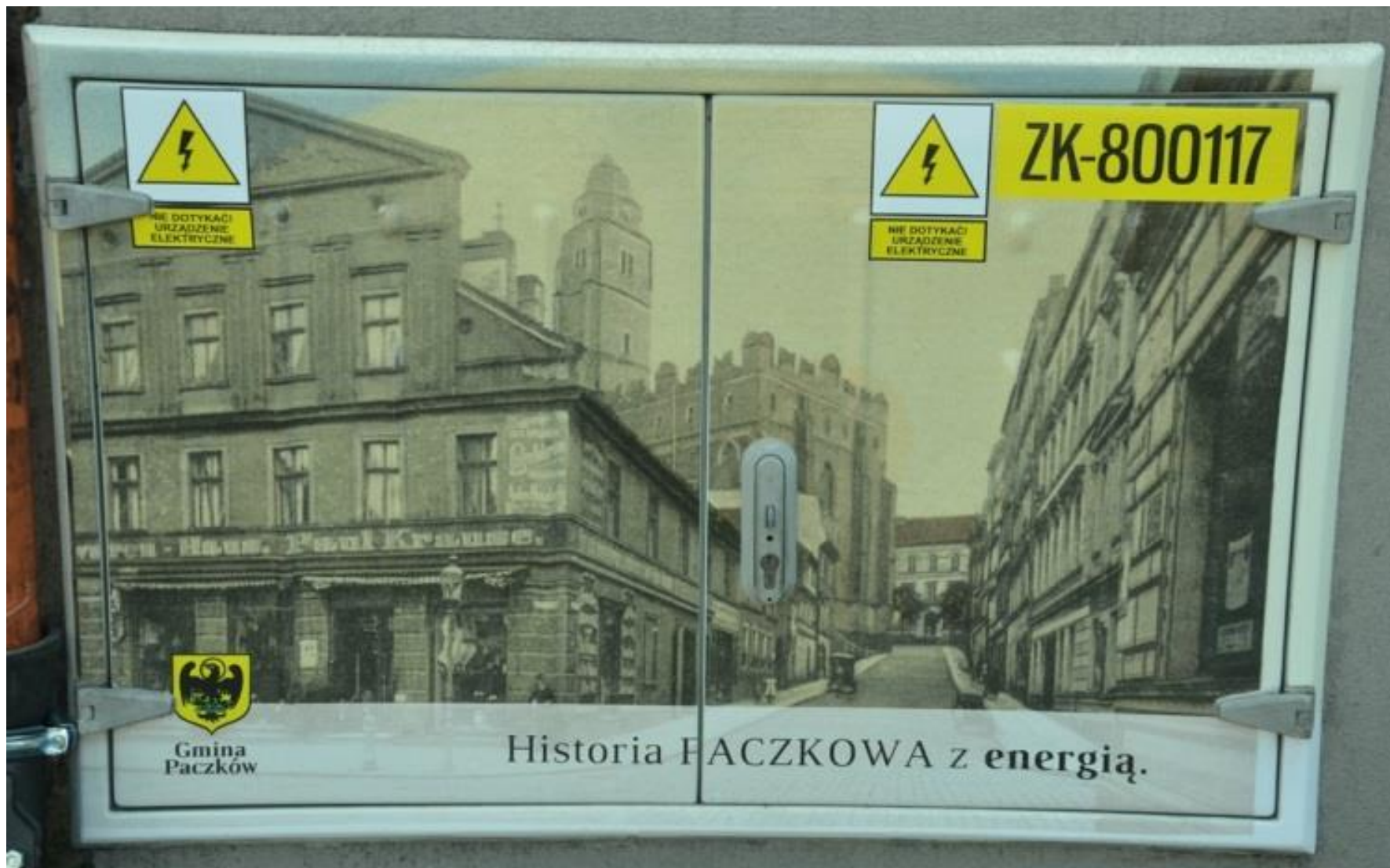
Zdjęcie 2 – Przykładowa skrzynka energetyczna; źródło: http://paczkow.pl/1868/historia-paczkowa-z-energia.html , data dostępu: 05.02.2019.
