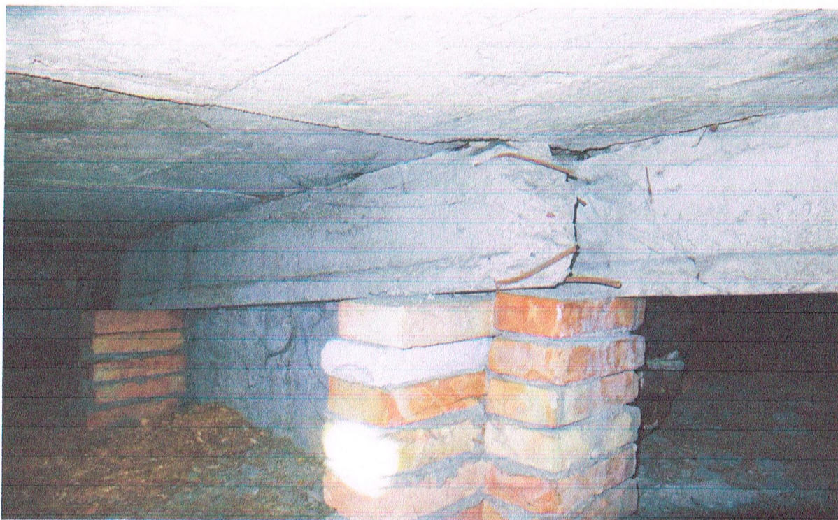
Fot. nr 7. Belka odcinkowa DMS przy kominie ( do wymiany na stalowe belki P 160 )
