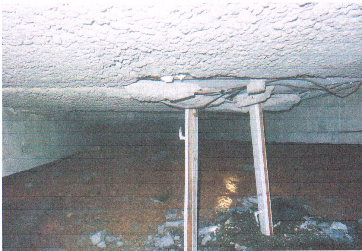
Fot. nr 10 . Uszkodzona płyta dachowa do wymiany.
