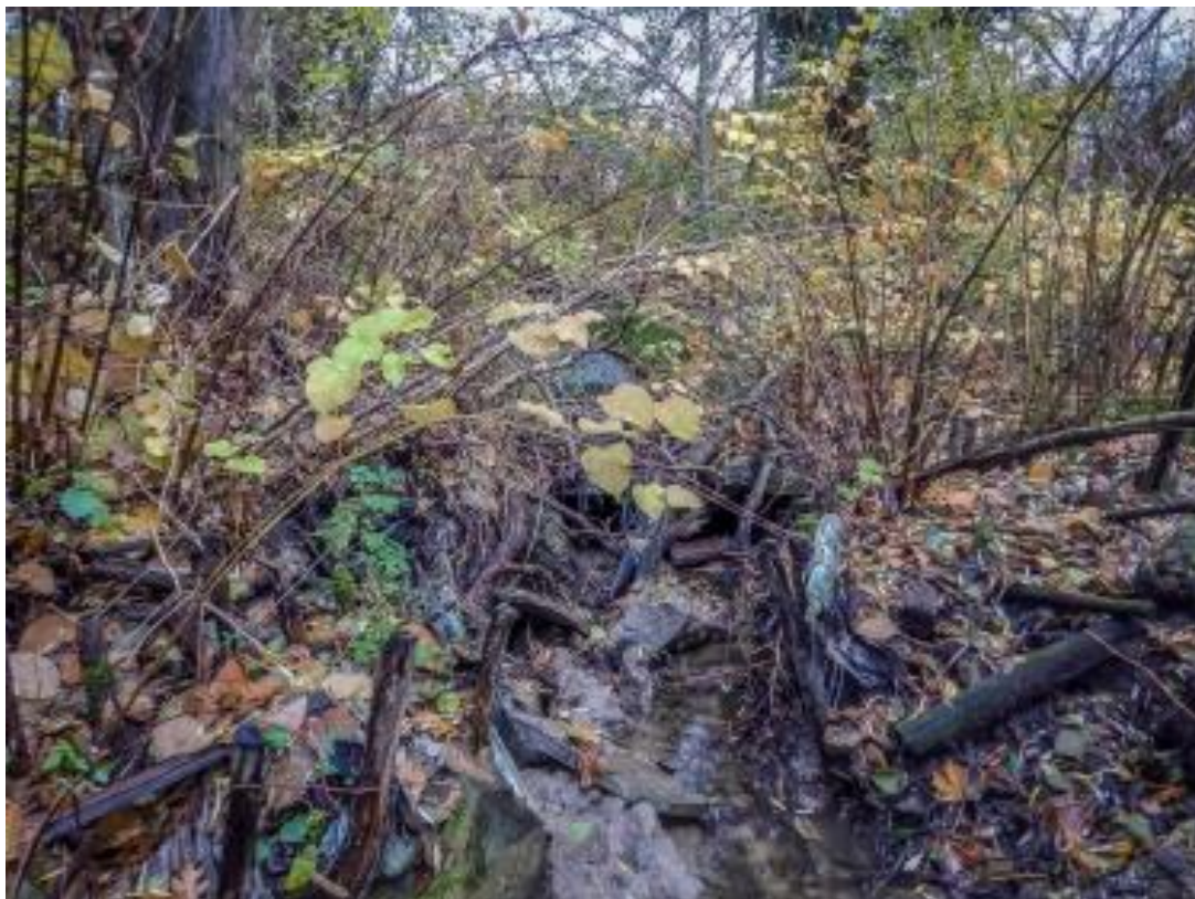
Fot. 1. Dalsza degradacja umocnienia skarpy na jęzorze osuwiska.
