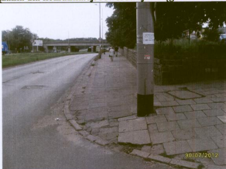
Brak odpowiedniej szerokości celem wydzielenia pasa ruchu dla rowerów na chodniku. Konieczność przestawienia latarni.
