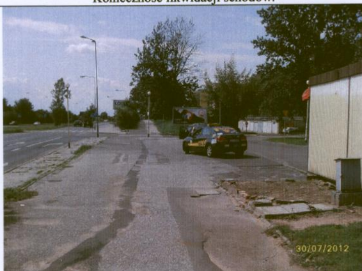
Konieczność miejscowych napraw nawierzchni.
