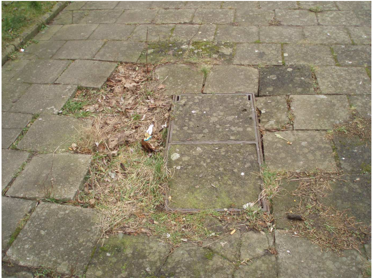
Chodnik, który stanowi przejście pomiędzy dwoma obiektami jest niekompletny
